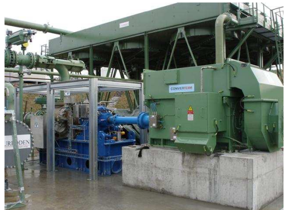
Figure 6 : Générateur (à droite) aligné avec la turbine (à gauche).
